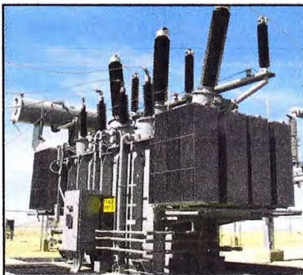
Figura 1.4: Transformadores de Potencia
