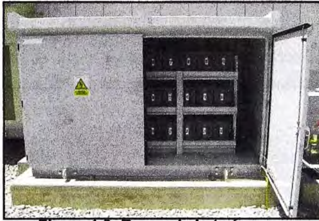
Figura 1.3: Banco de baterías
