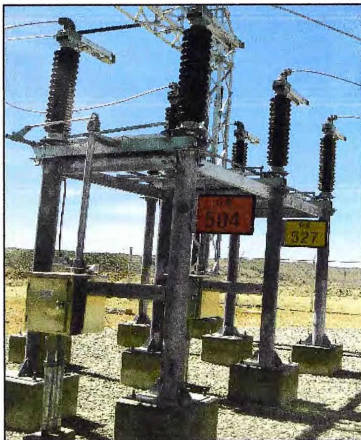
Figura 1.6: Seccionador o Cuchillas de puesta a tierra
