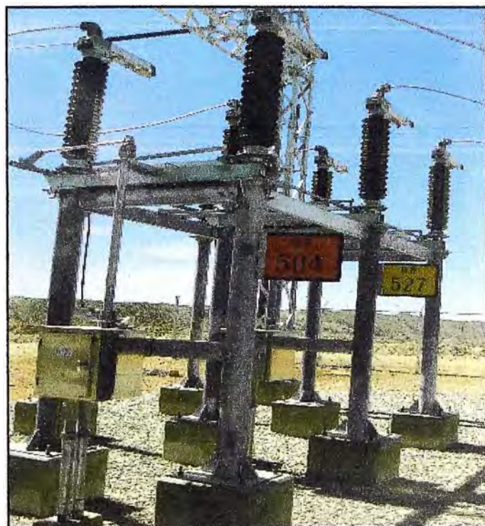
Seccionadores de potencia "GS - 504 y DS - 527"
