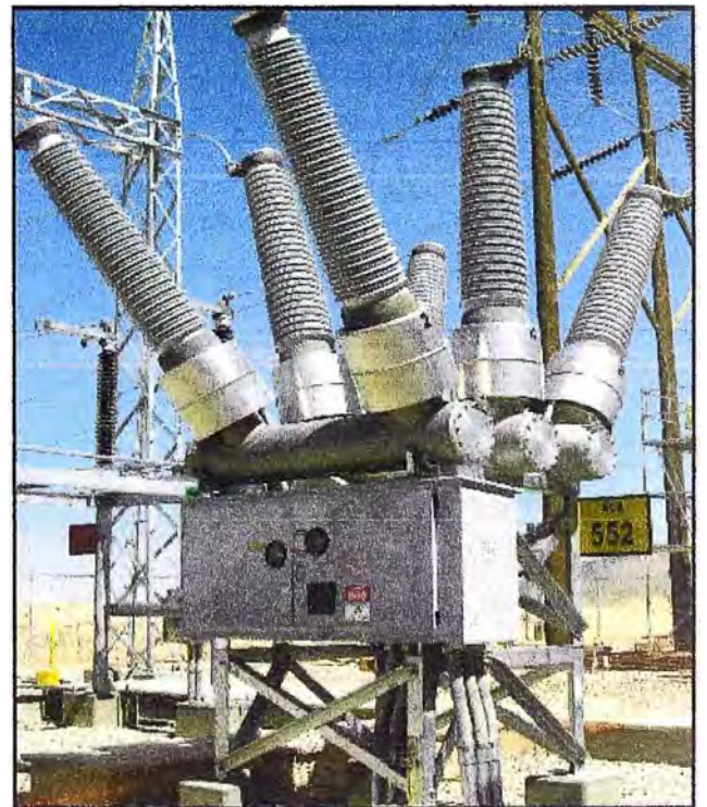
Interruptor de potencia "HCB - 552"
